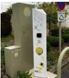
104 bornes accélérées (22 kVa)
